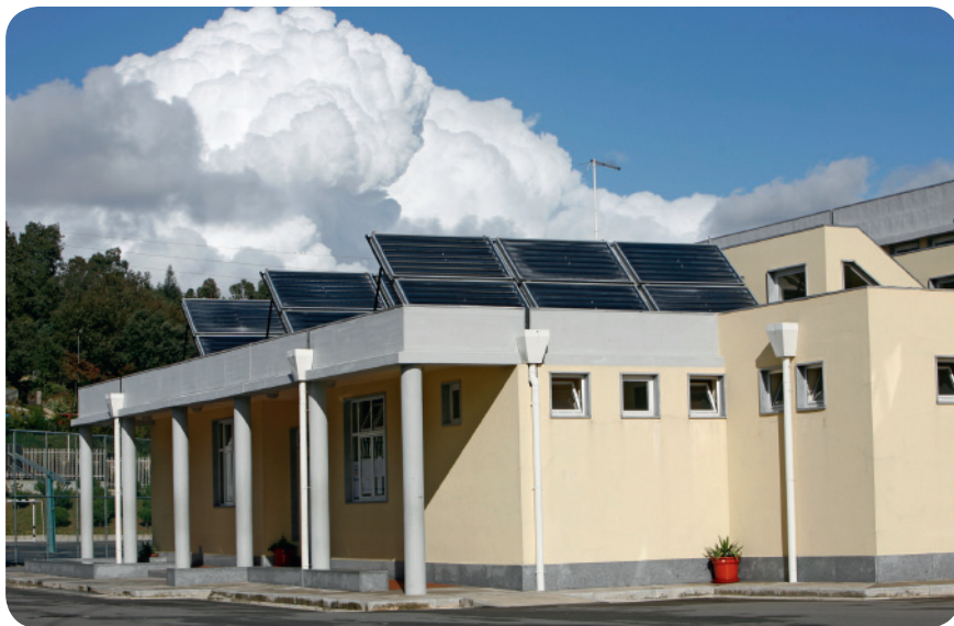
Fig. A Sistema solar para aquecimento das águas de piscina e balneários.
