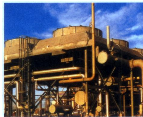
Doc. 8 Central geotérmica nos Açores, onde se produz eletricidade a partir do calor da Terra.
