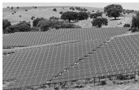
Doc. 7 – Painéis solares.
