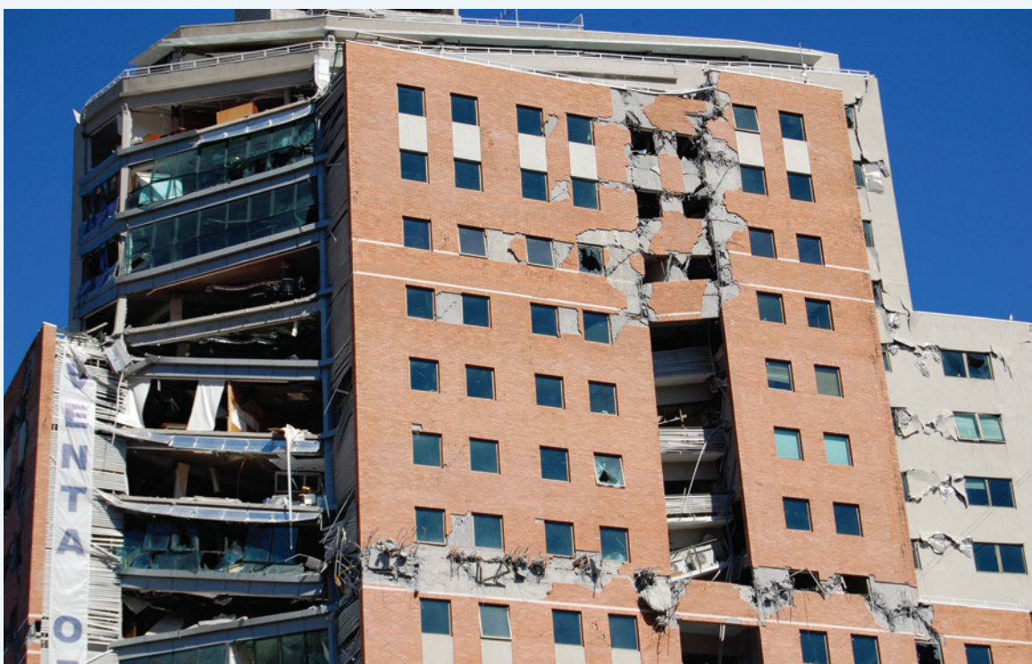
3 Destruição causada pelo sismo de 2010 no Chile.
