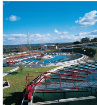
[9] Decantador usado numa estação de tratamento de águas residuais.
