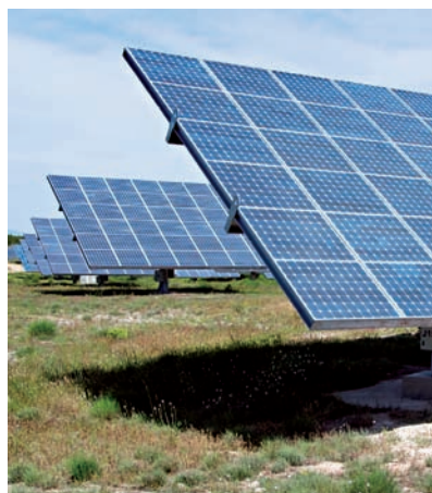
8 Painéis solares virados a sul.
