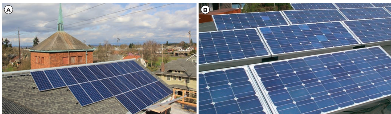
Fig. 30 Painel solar térmico [A] e painel solar fotovoltaico [B].
