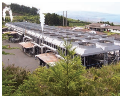
Fig. 37 Central geotérmica da Ribeira Grande, Açores.
